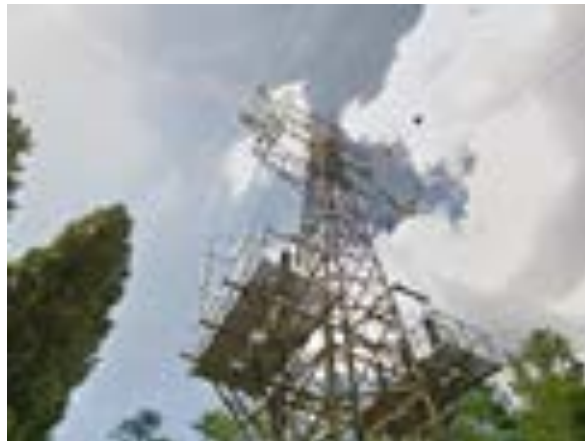
ELMŰ 120 kV-os légvezeték hálózat kábelfejes oszlopa
