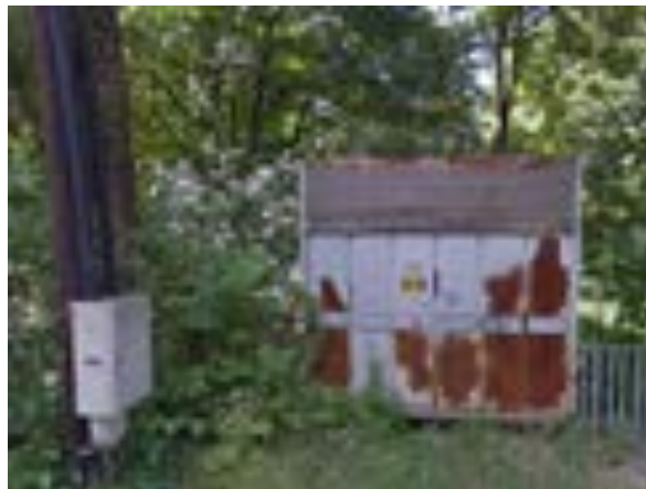
4103-as sz. lemezházaz 10/0,4 kV-os transzformátor
