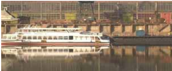
Rossz műszaki állapotú támfalak
