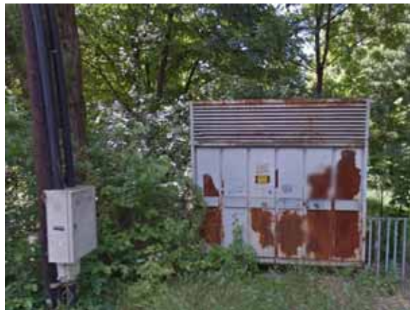
4103-as sz. lemezházaz 10/0,4 kV-os transzformátor
