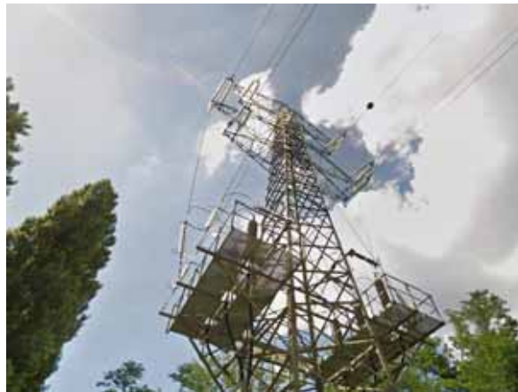
ELMŰ 120 kV-os légvezetékes hálózat kábelfejes oszlopa
