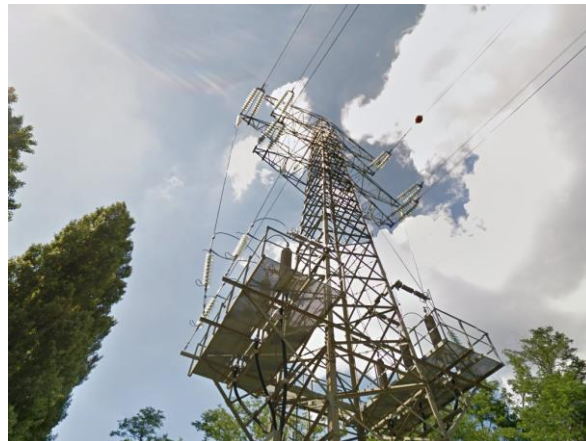
ELMŰ 120 kV-os légvezeték hálózat kábelfejes oszlopa
