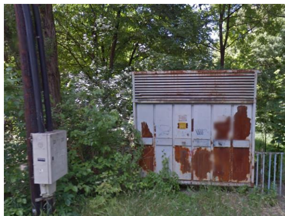
4103-as sz. lemezházaz 10/0,4 kV-os transzformátor
