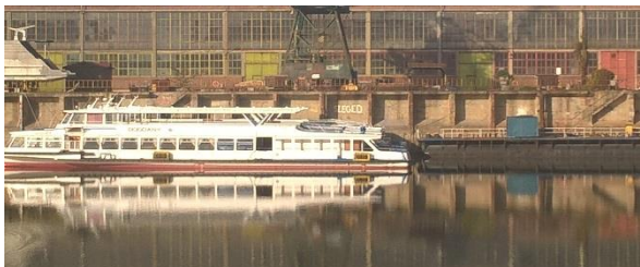
Rossz műszaki állapotú támfalak
